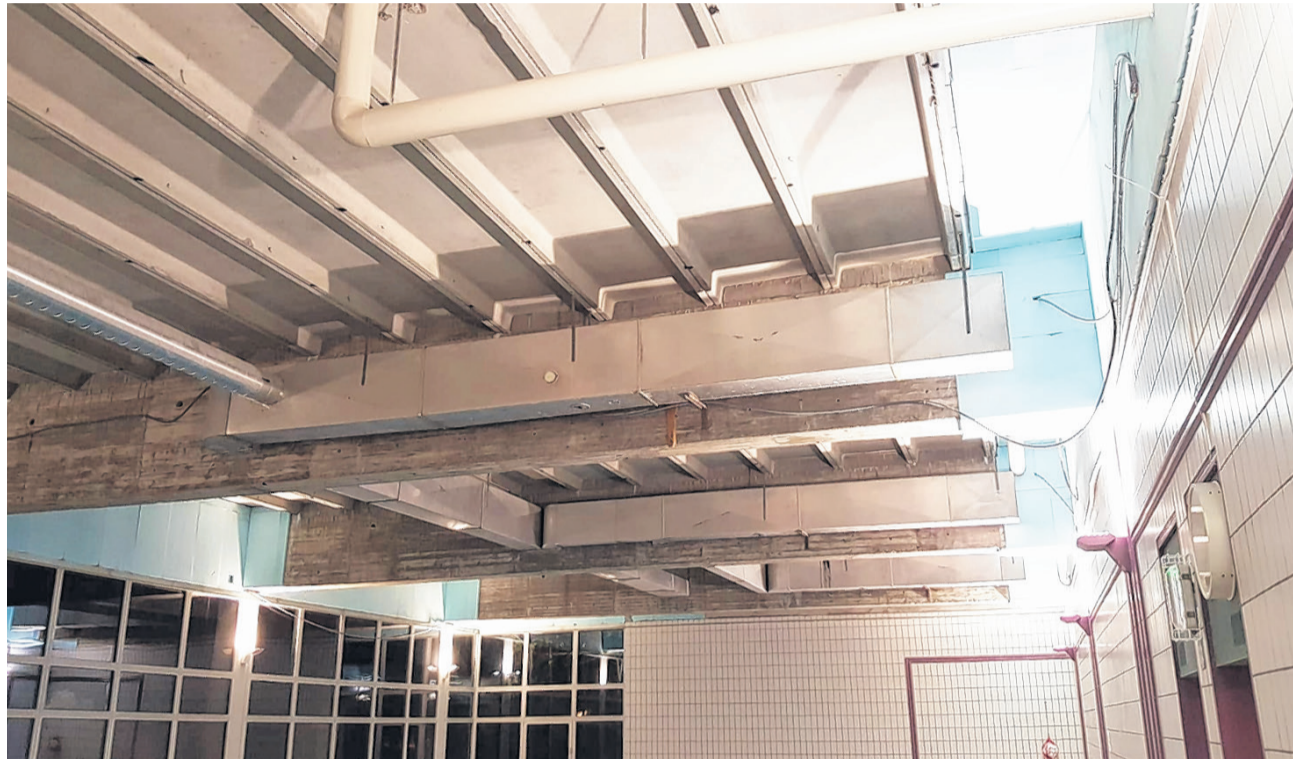
Seit die überhängende Decke im Hallenbad abgenommen wurde, hat sich die Akustik im Hallenbad Seefeld Lachen merklich verschlechtert. Der Gemeinderat Lachen findet die Lärmsituation «verkräftbar». Mehr investieren will er nicht.
